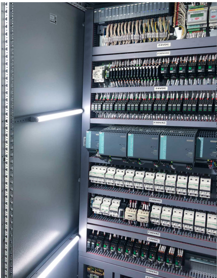
Шкаф управления ванной цинкования
